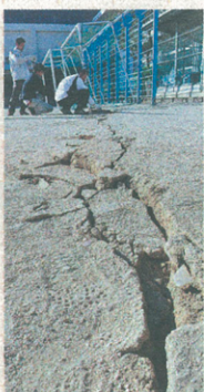
兵庫県の淡路島を襲った震度6弱の地震で亀裂が入ったグラウンド
